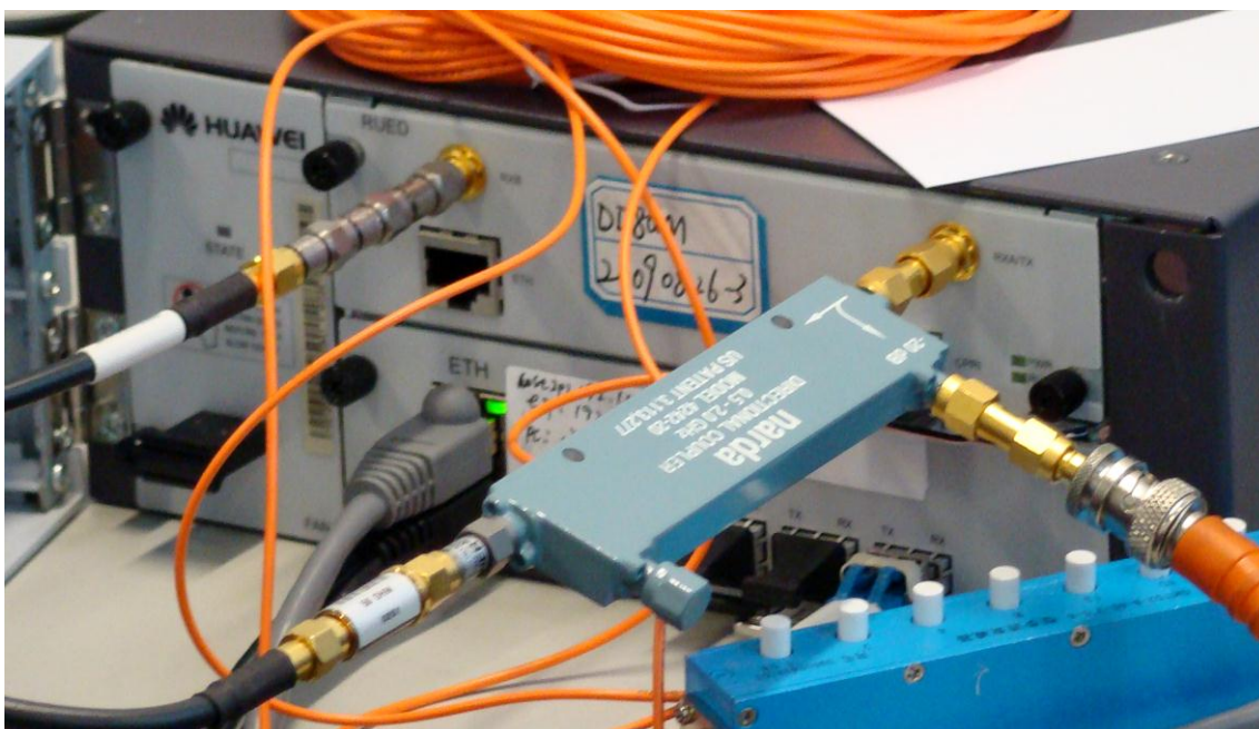
Terminalgerät, Breitbandkoppler und Dämpfungsglieder
