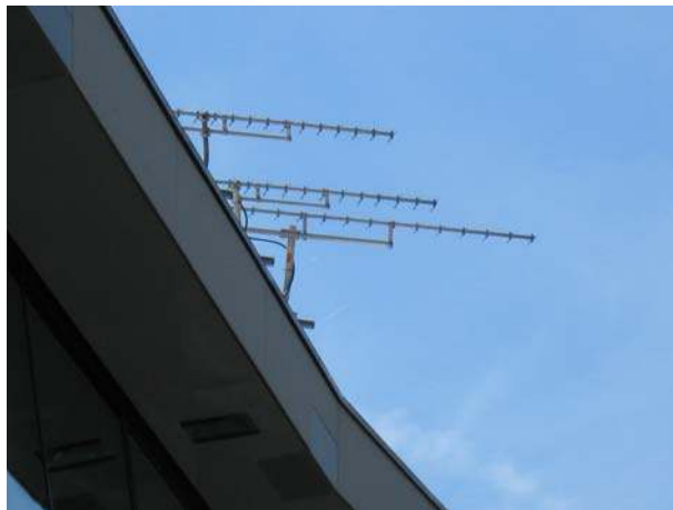
Empfangsantennen auf dem Dach
