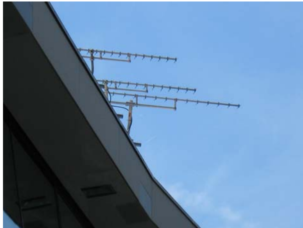
Empfangsantennen auf dem Dach
